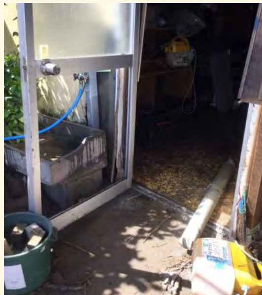
畳屋さんの工場の入り口。ドアの下半分は濁流が流れ込んで割れ落ち、床には泥が堆積している(7日午後)。
