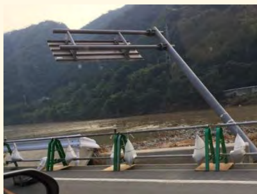
国道180号線沿いの道路標識は水流で傾いたまま。
